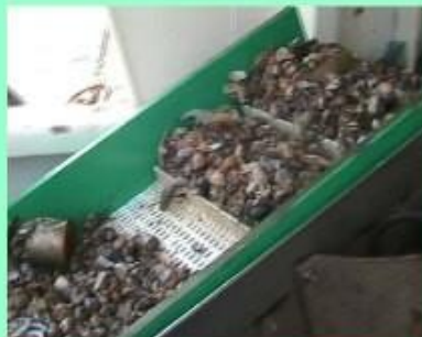
Nastro di carico e lavaggio
